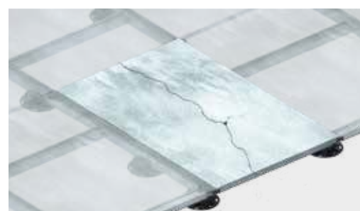
Zwiększone ryzyko pęknięcia poszczególnych płyt z powodu braku profili podpierających profile.
