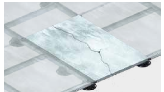
Erhöhte Bruchgefahr einzelner Platten aufgrund fehlender Stützprofile.
